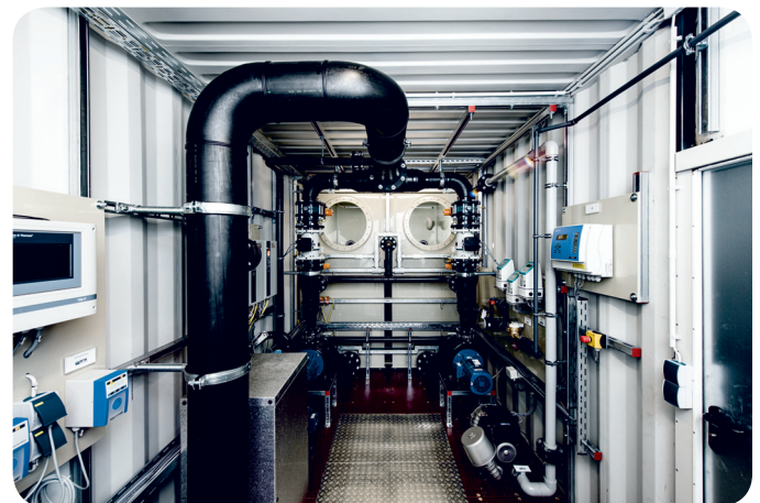
Abbildung 5: Filter im Container, Quelle: WTA Vogtland GmbH
