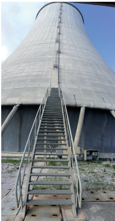
Foto 8: Kühlturm in Portugal während der Desinfektion
